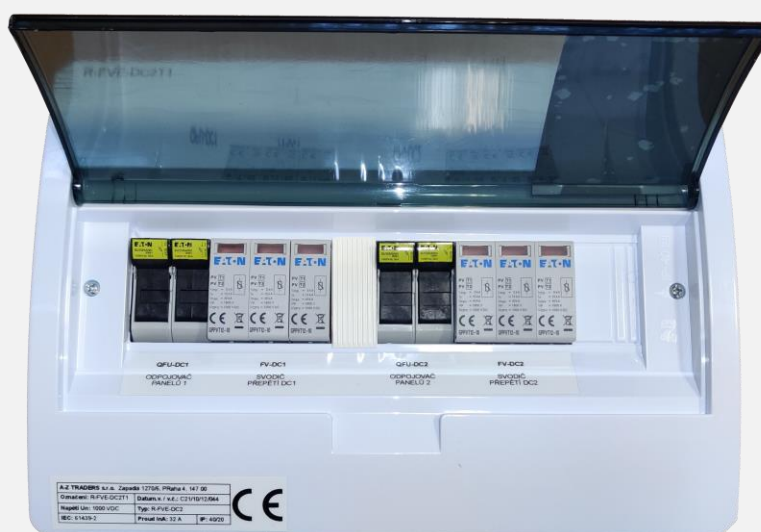
Rozvaděč R-FVE DCxx (pro 2 stringy)
